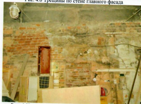
Рис. 4.8 Разрушение кирпичной кладки несущей стены
