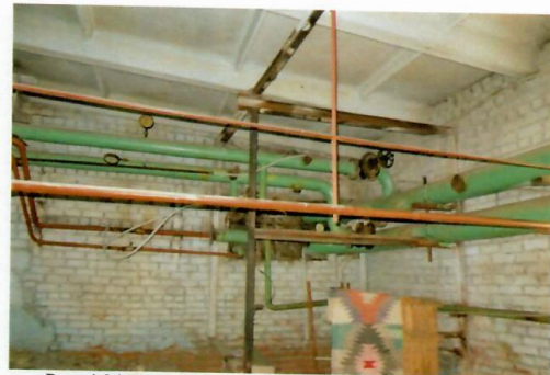
Рис. 4.24 Помещение под дизельную ёмкость (резерв)
