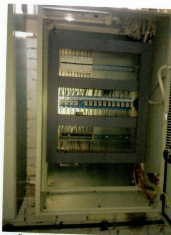
Рис. 4.42 Шкаф управления Котлом
