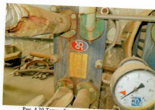
Рис. 4.30 Теплообменники ГВС пластинчатые
