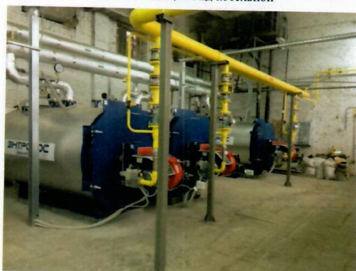
Рис. 4.57 Общий вид котлов (КВ-ГМ-3-115 -3шт)
