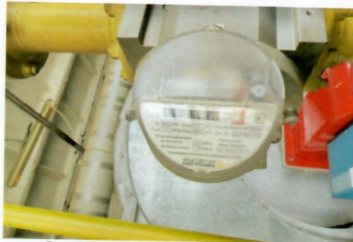
Рис. 4.21 Прибор учета расхода газа котла № 3
