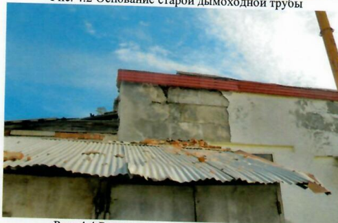
Рис. 4.4 Разрушение внешней стены здания
