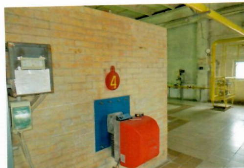
Рис. 4.86 Горелка дизельная котла №4
