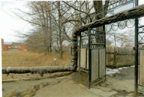
Рис. 4.103 Надземный переход теплотрассы над проездом
