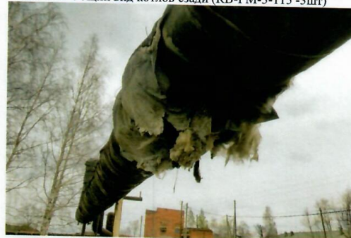
Рис. 4.60 Частичное разрушение теплоизоляции
