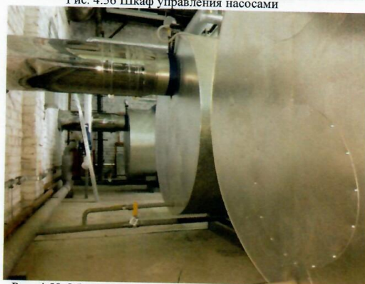
Рис. 4.58 Общий вид котлов сзади (КВ-ГМ-3-115 -3шт)
