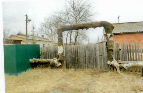
Рис. 4.134 Переход теплотрассы над проездом к жилому дому
