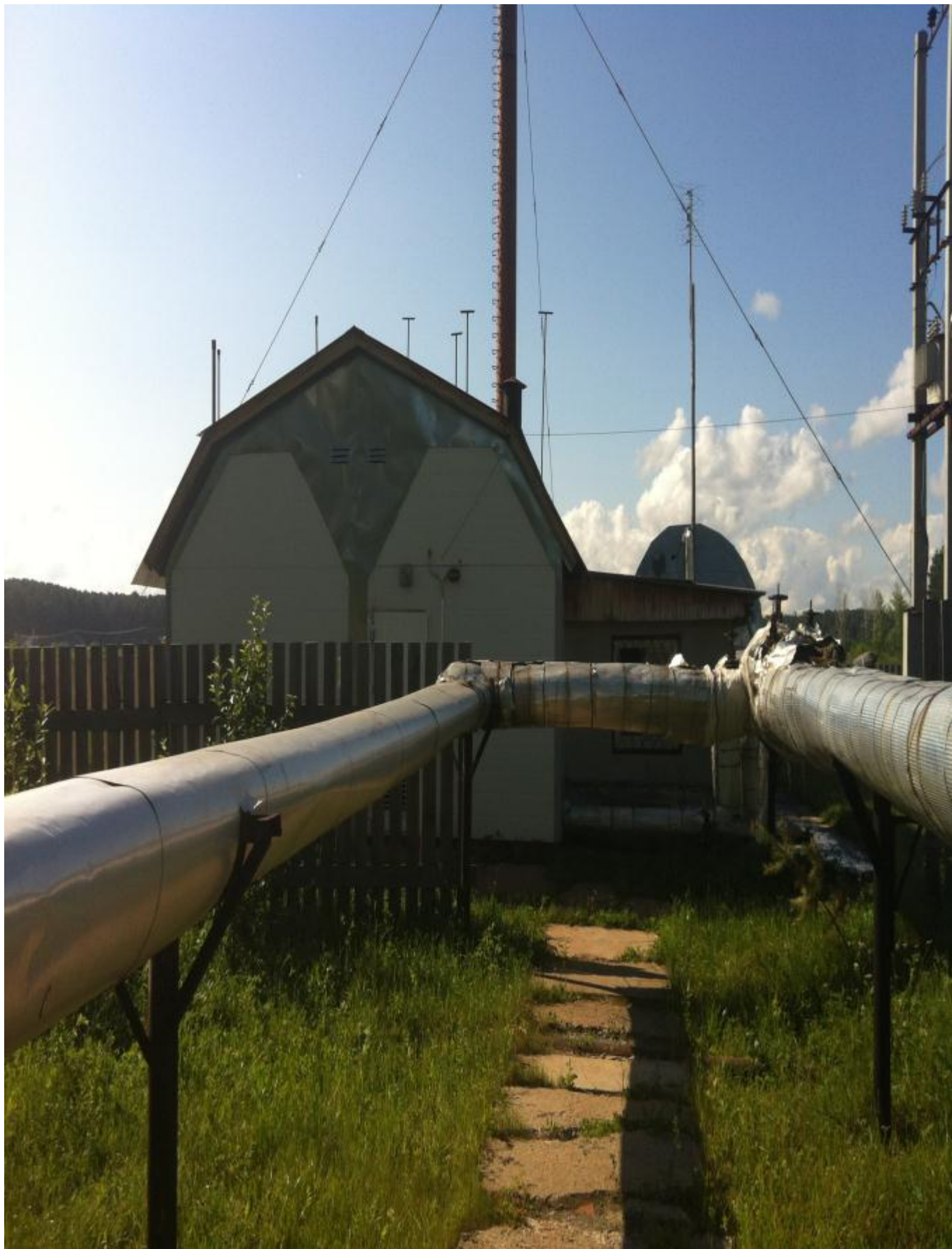
1.2.4. Газовая котельная п. Верхняя Сысерть.
