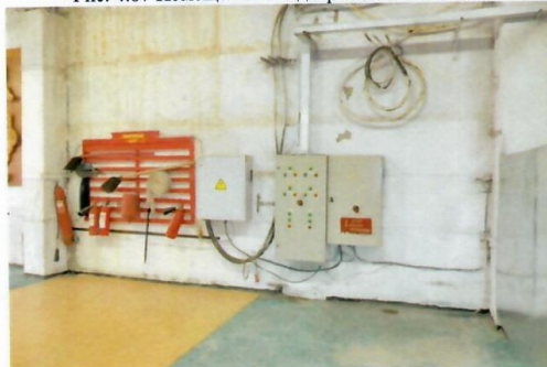
Рис. 4.89 Шкафы управления и учета
