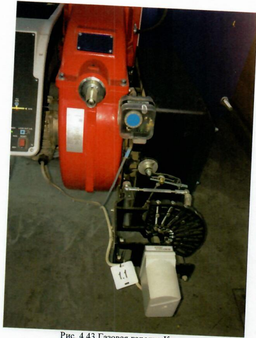
Рис. 4.43 Газовая горелка Котла
