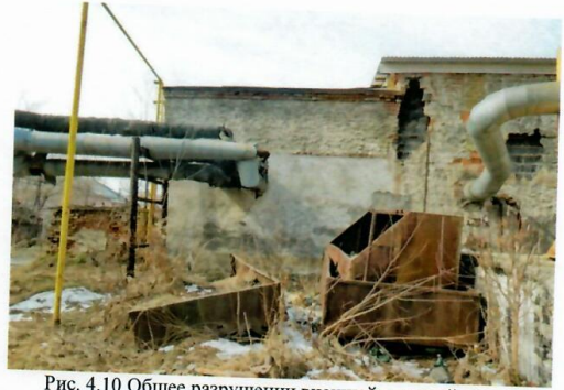
Рис. 4.10 Общее разрушение внешней несущей стены
