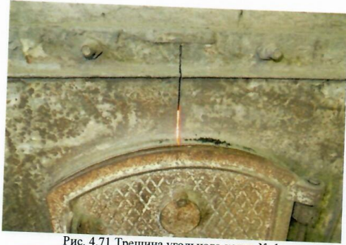
Рис. 4.71 Трещина угольного котла № 1
