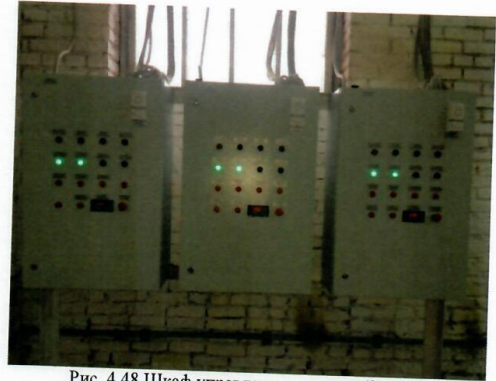
Рис. 4.48 Шкаф управления котлами (3шт)
