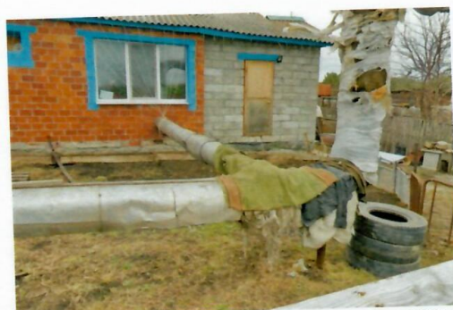
Рис. 4.137 Ввод в жилой дом. Разрушение теплоизоляции
