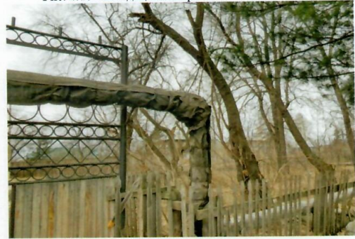
Рис. 4.104 Надземный переход теплотрассы над проездом
