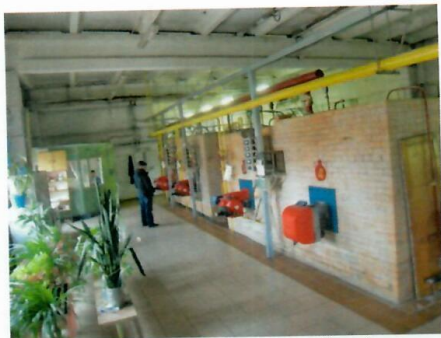
Рис. 4.85 Водогрейные котлы (4 шт.)
