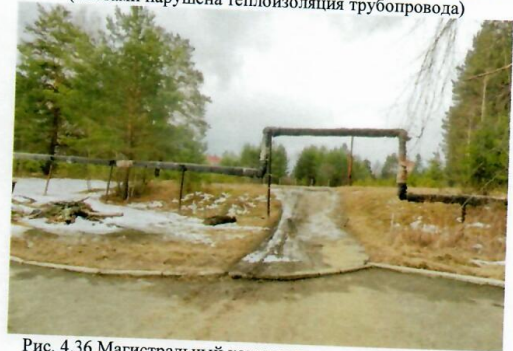
Рис. 4.36 Магистральный компенсатор системы отопления
