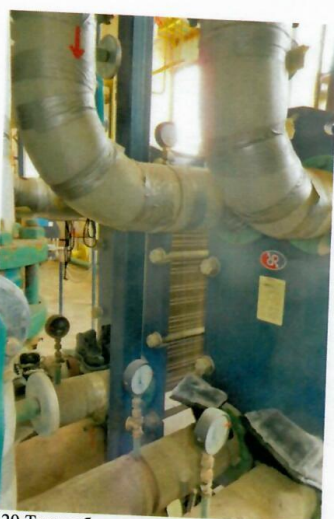
Рис. 4.29 Теплообменники отопления пластинчатые
