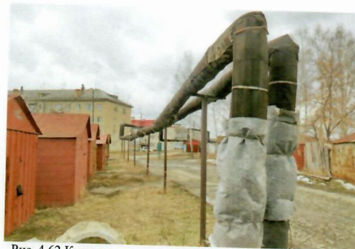
Рис. 4.62 Колодец магистральный тепловой сети Т1иТ2
