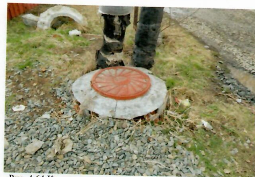
Рис. 4.64 Колодец магистральный тепловой сети Т1иТ2
