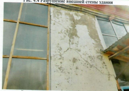
Рис. 4.6 Трещины по стене главного фасада
