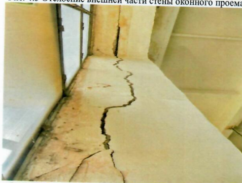
Рис. 4.7 Трещины по несущей стене внутри помещения
