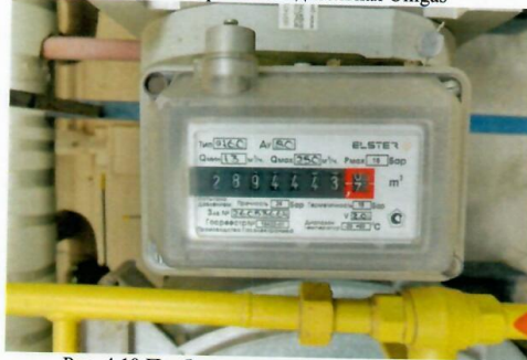
Рис. 4.19 Прибор учета расхода газа котла № 1
