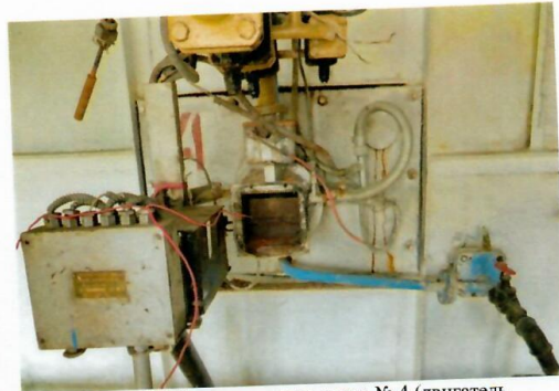
Рис. 4.132 Газовая горелка котла № 4 (двигатель демонтирован)
