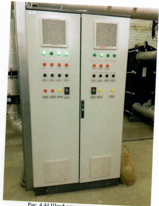
Рис. 4.44 Шкаф управления насосами
