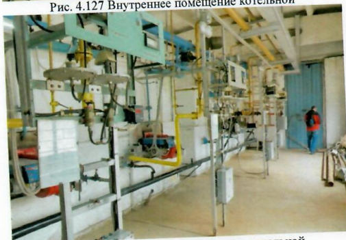
Рис. 4.129 Внутреннее помещение котельной
