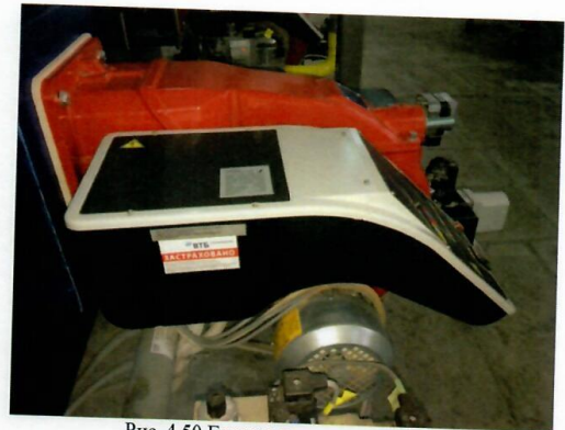
Рис. 4.50 Газовая горелка котла
