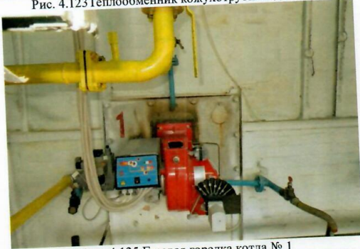
Рис. 4.125 Газовая горелка котла № 1
