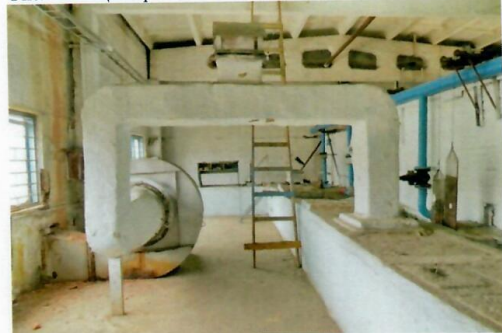
Рис. 4.110 Дымосос внутри помещения котельной
