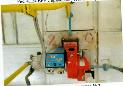
Рис. 4.126 Газовая горелка котла № 2
