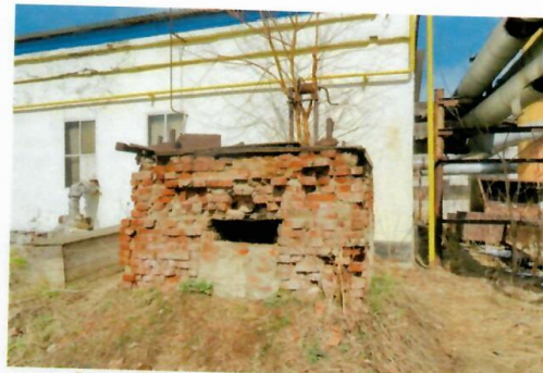
Рис. 4.2 Основание старой дымоходной трубы
