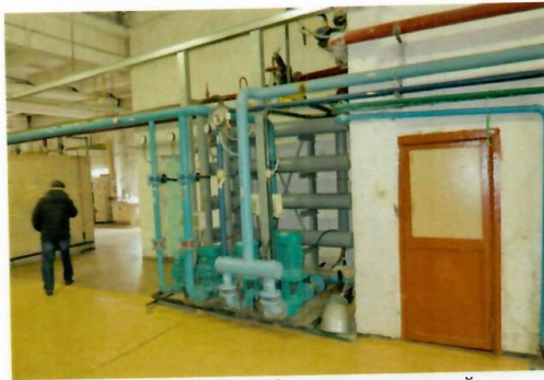
Рис. 4.93 Насосное оборудование котельной
