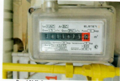
Рис. 4.20 Прибор учета расхода газа котла № 2
