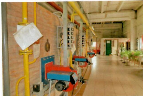
Рис. 4.87 Помещение с водогрейными котлами
